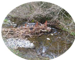
Encombrement de pièges à embâcles
